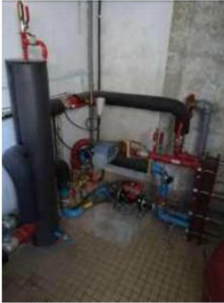
Arrivée réseau de chaleur + échangeur primaire
